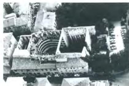
Fig. 3.1 – Teatro La Fenice di Senigallia dopo il bombardamento subito durante la seconda guerra mondiale. È facilmente distinguibile dall'immagine l'involucro esterno in muratura che avvolge la sala e il palcoscenico.
