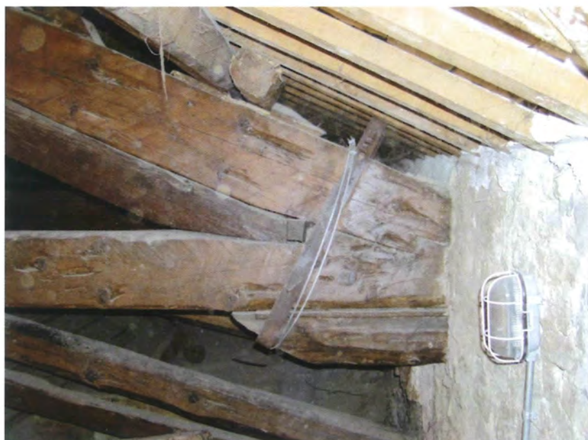
Fig. 4.84 - Teatro Serpente Aureo di Offida (AP). Unione a semplice dente per il sottopuntone (rinforzata da una bietta in legno duro) e a doppio dente per il puntone.
