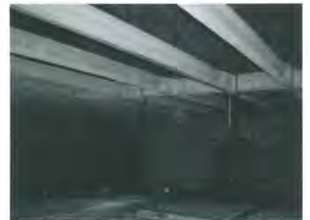
Fig. 2.6 - Teatro Comunale di Caldarola (MC). Intervento degli anni '70 di sostituzione delle capriate lignee con capriate in c.c.a.
