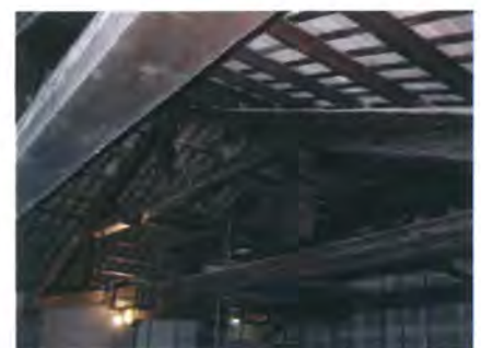
Fig. 4.71 e Fig. 4.72 - Sopra: cavalletto composto del Teatro Argentino (Pizzagalli, 1827, Tav. X). Sotto: esempio di capriata composta (Teatro Comunale di Chiaravalle, AN).
