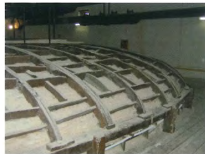
Fig. 4.47 – Teatro Comunale di Chiaravalle (AN). Si notano i pilastri in legno che sono collegati da una "cordolatura" in legno su cui vanno ad ancorarsi le cantine che sorreggono il plafone della sala.
