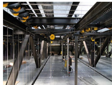
Obermaschinerie, begehbare Fläche über Bühne
