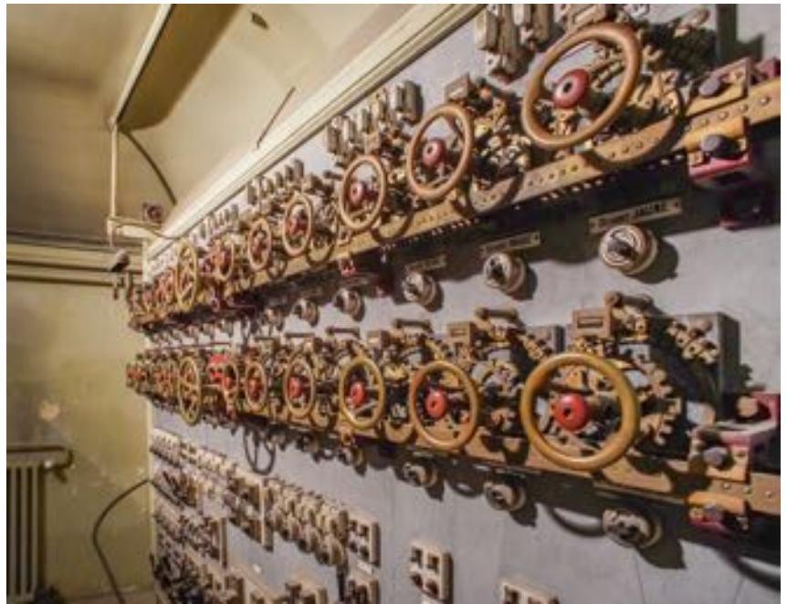
Abb. 20: Schalttafel anno 1911 mit Stufenschaltern und blanken Drahtsicherungen, die roten Knöpfe kuppeln ein.
