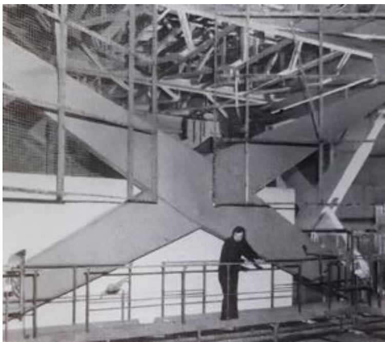
oben: Untermaschinerie: Kellergeschoss, Stabilisierungsscheren Hubturm T1 und T2
