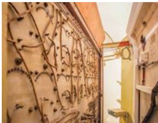
Abb. 21: Rückansicht der Schalttafel mit abgeklemmten Kabeln
