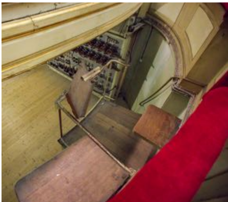
Abb. 14: Blick von oben in den Orchesterraum mit Dirigentenpult, rechts die Schalttafel
