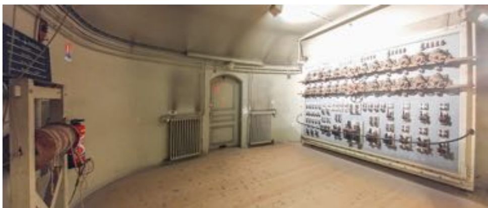
Abb. 18: Raum unter der Bühne mit Schalttafel und Vorhangzug (links)
